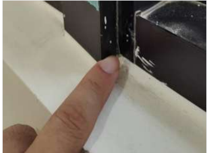
● 窗框烤漆刮傷、碰角破損
